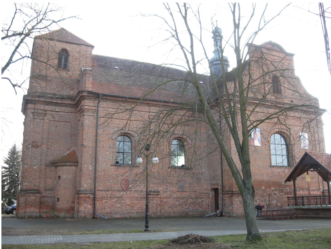
Fot. 1. Widok ogólny kościoła ( dachu i zawilgoconej zach. ściany ) ;
