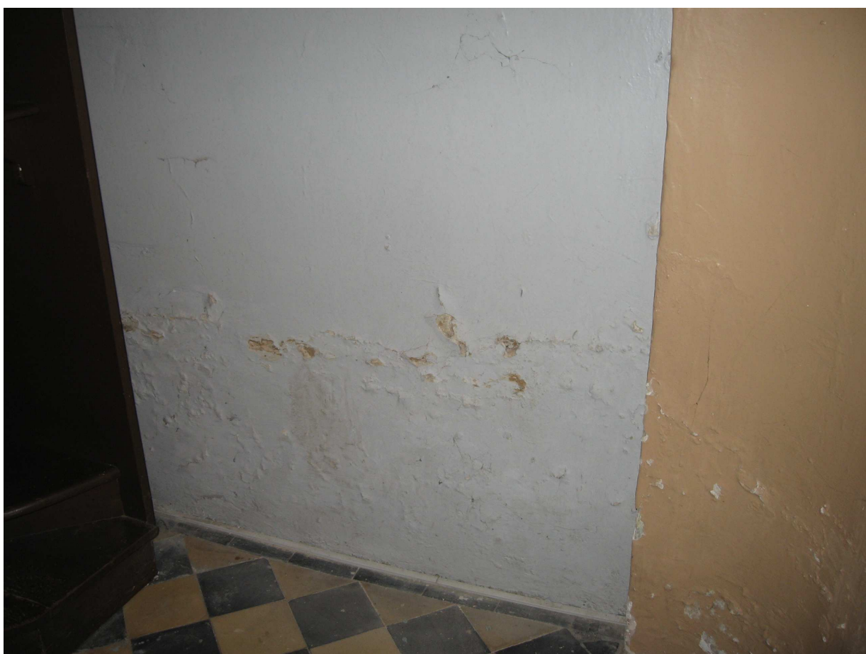
Fot. 4. Widok zawilgoconej ściany od wnętrza kościoła ;
