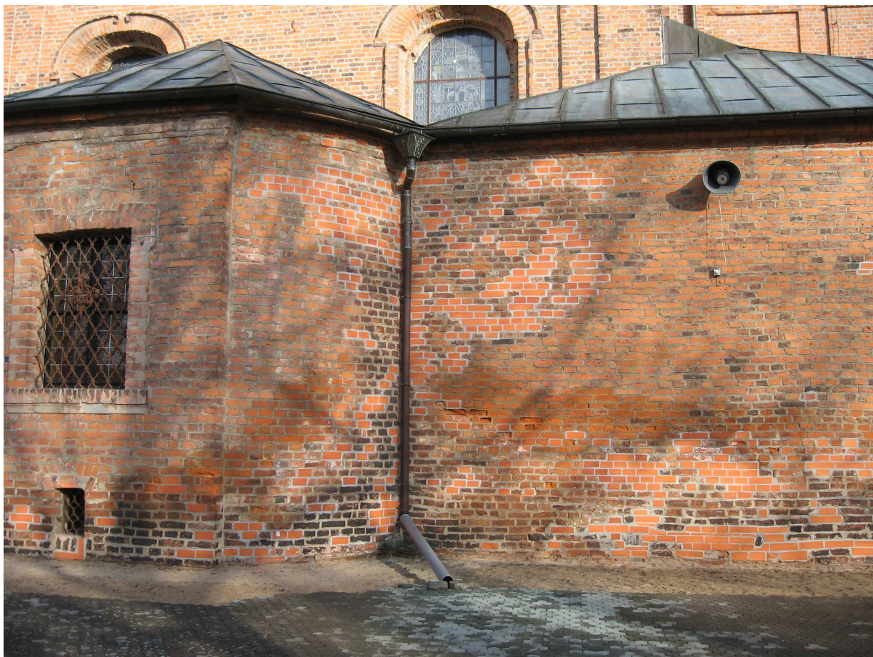
Fot. 3. Widok fragmentu elewacji południowej (zawilgoconej ściany i wtórnych cegieł) ;
