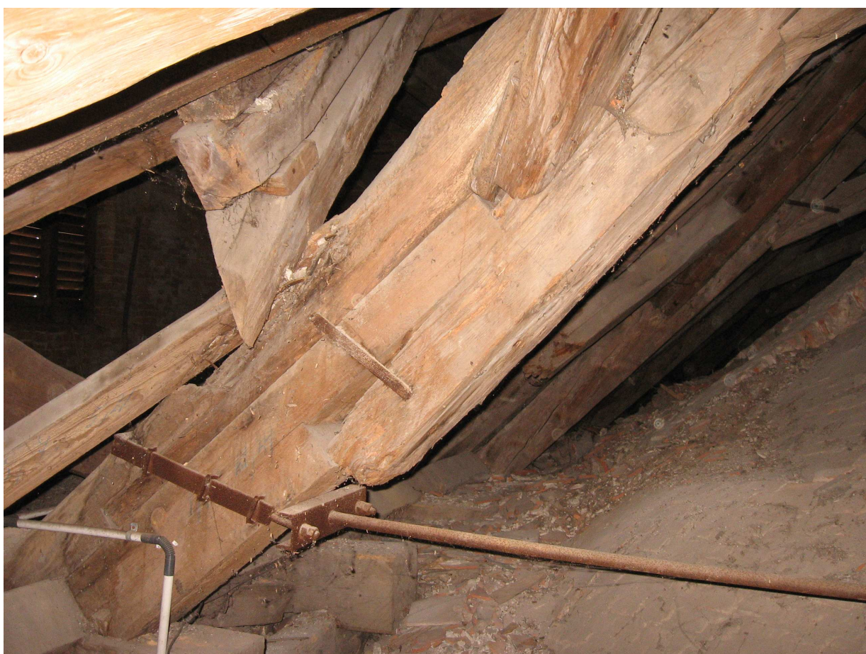
Fot. 8. Widok uszkodzonego dachowego wężara rozporowego.
