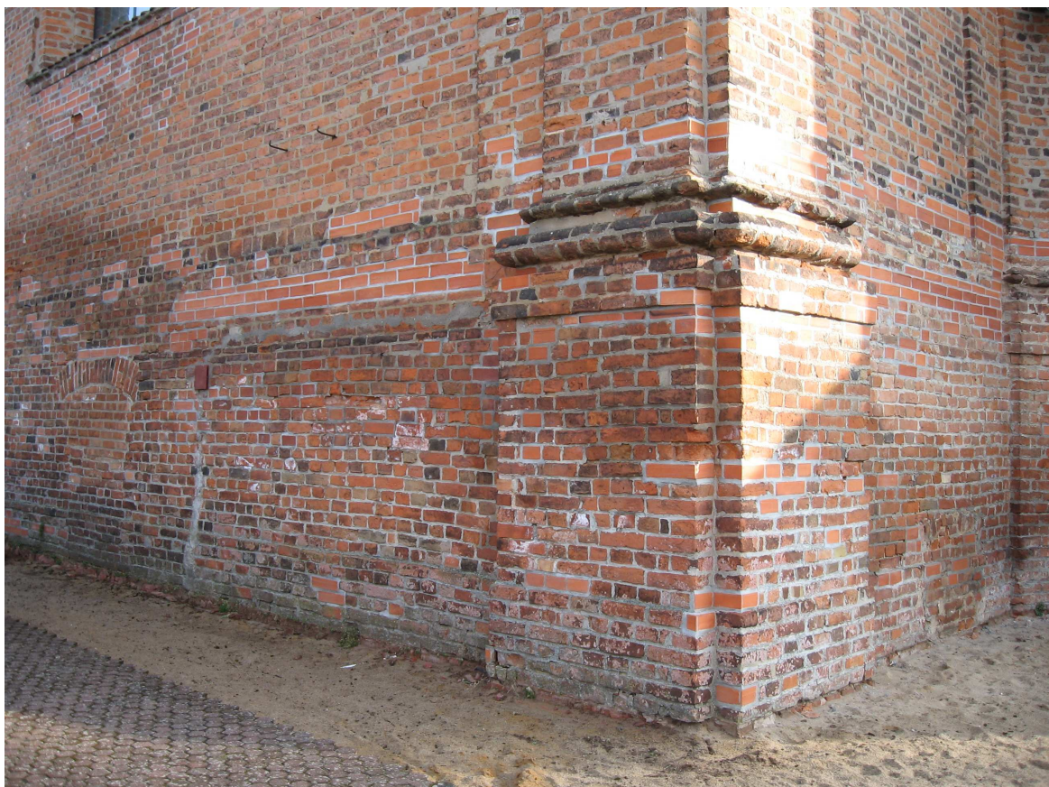
Fot. 2. Widok zawilgoconej ściany i wtórnie wmurowanych cegieł i płytek ;
